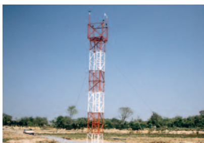
Nouvel emplacement du pylone anémomètre
