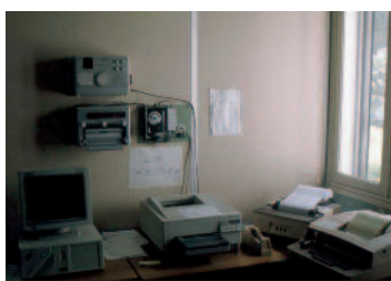
Salle de transmission
