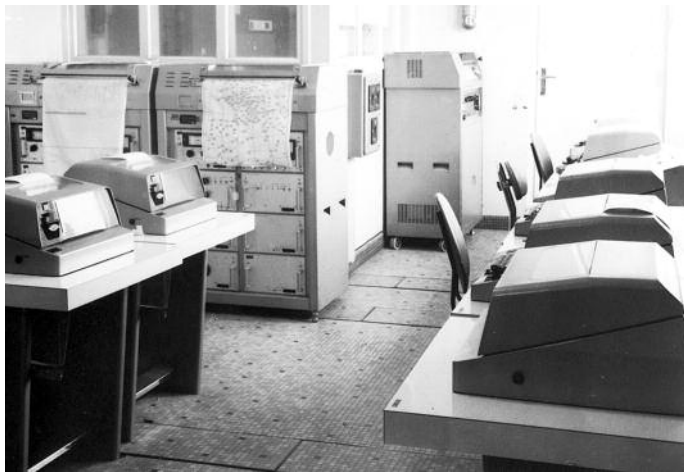
Salle des transmissions
